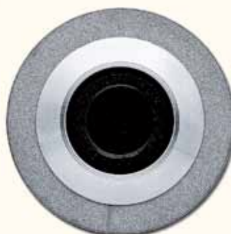
Sensor de Faíscas Instalado (visto do interior do duto)
