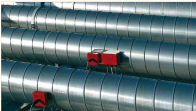
Dutos de exaustão com os sensores de faíscas instalados
